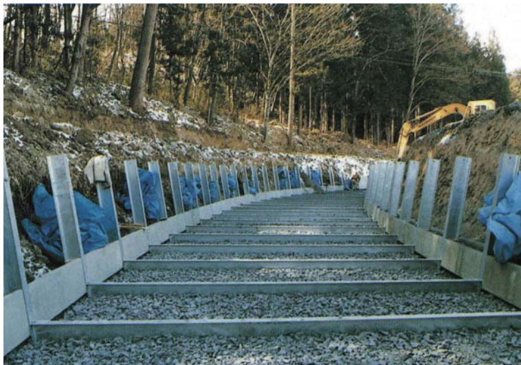
岩手県花泉町涌津地区排水路 (S57年施工) (両磐土地改良事業所) B4600/5100×H1.5m 上開きタイプ
