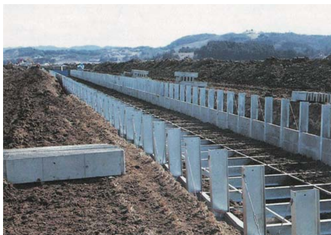
岩手県花泉町西沢堀排水路 (両磐土地改良事業所) B5.0m×H1.6m 支柱タイロット締付工法採用 (S61年施工)
